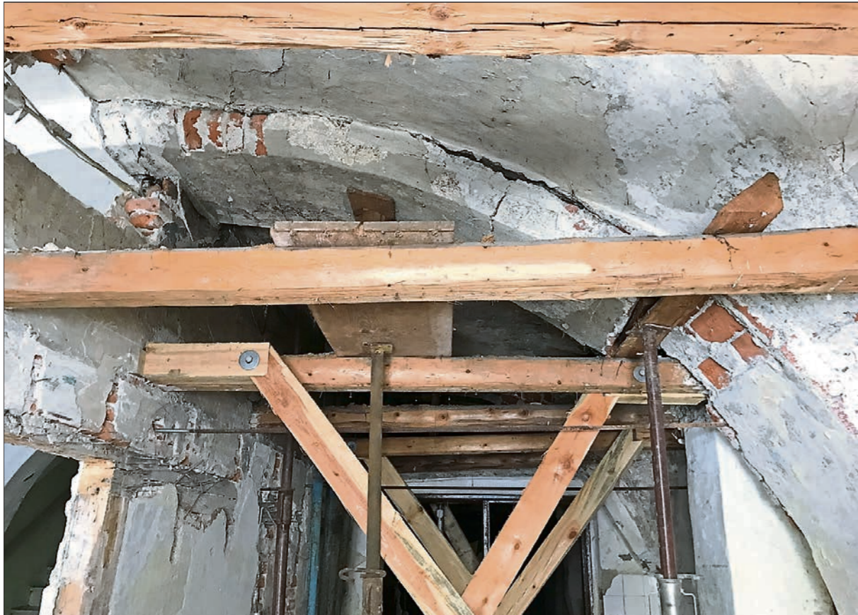
Gewölbeschaden und Gewölbereparatur. am ehemaligen Messbundhaus in Neuötting.
